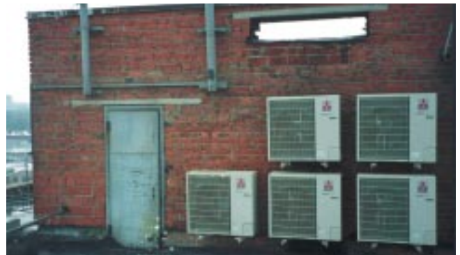
Фото 2. Базовая станция размещена в чердачном помещении многоэтажного дома
