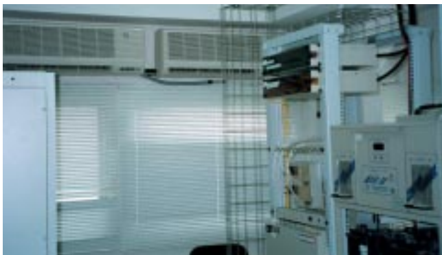
Фото 1. Настенные внутренние блоки установлены в помещении базовой станции
