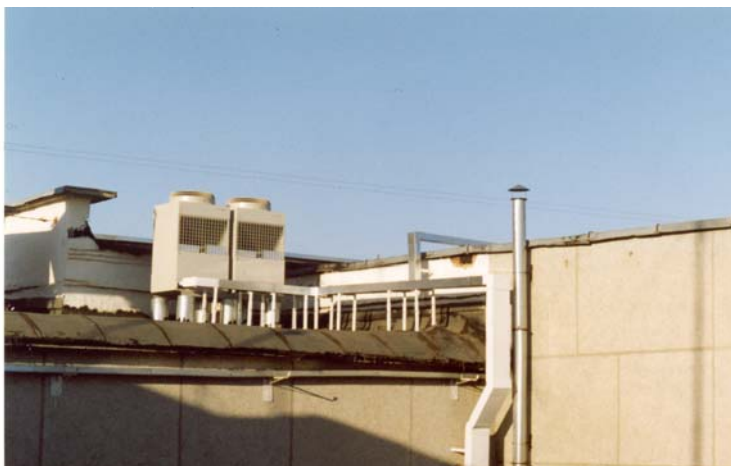
Мультизональные системы Сити Мульти на здании саратовского филиала ЦБ РФ
