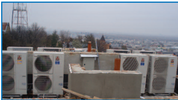
■ Расположение тепловых насосов ZUBADAN на кровле здания
