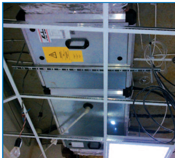
■ Приточная установка подключена к тепловому насосу
